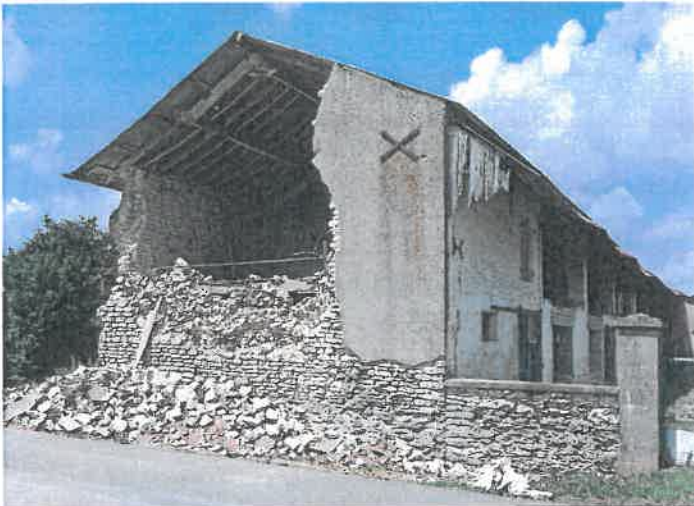
Séisme du 16 juin 2023 sur la commune de La Laigne (17)
