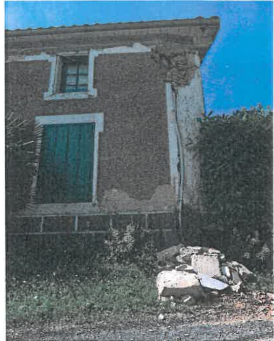
Séisme du 16 juin 2023 sur la commune de La Laigne (17)
